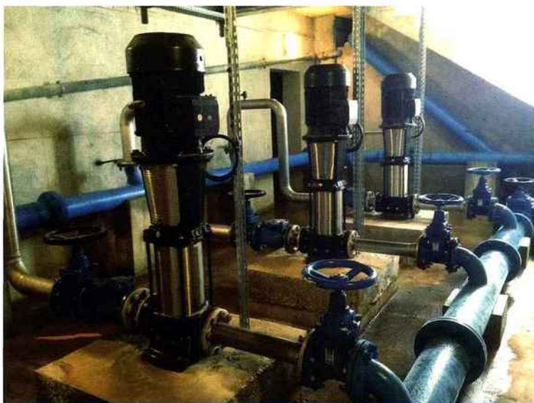
Une stratégie de pompage optimisée et régulièrement actualisée permet de réaliser d'importantes économies en énergie.
